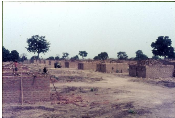
Figura 5 - Construção do reordenamento de Nhabijões [Fonte: Acervo pessoal do Eng. Simões Santos]
